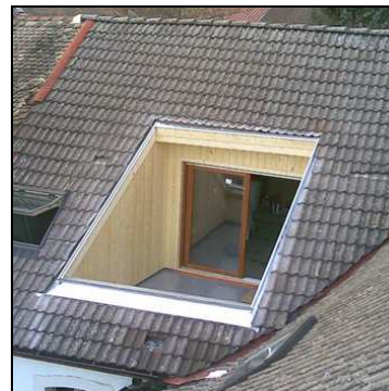
Défoncé de toiture
