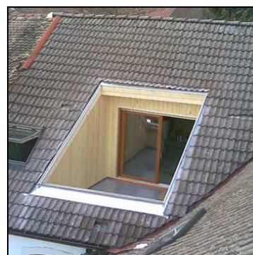
Défoncé de toiture
