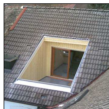
Défoncé de toiture
