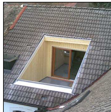
Défoncé de toiture
